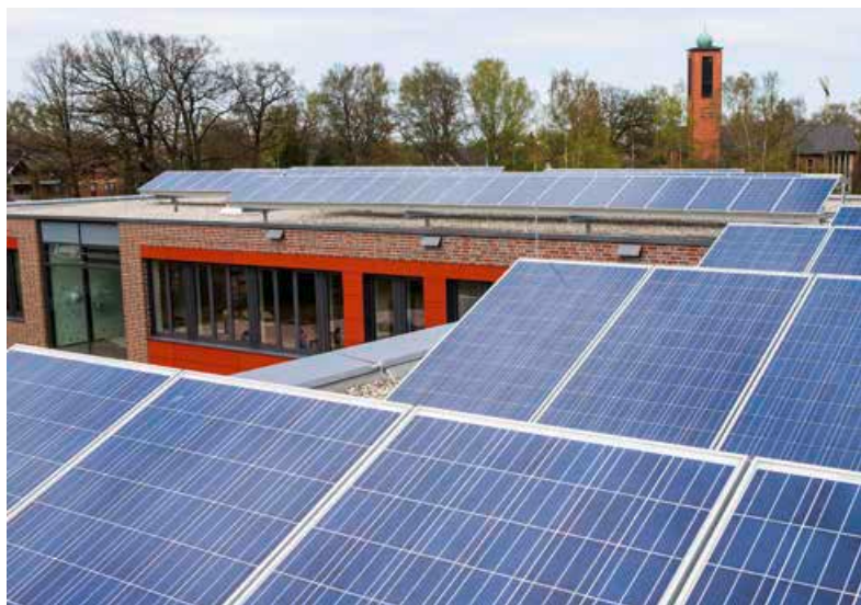
Die Solaranlage der Gemeindewerke auf dem Dach der Grund- und Gemeinschaftsschule an der Bek.
