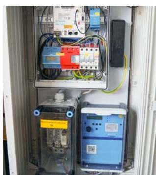
Schrank mit Steuerung
