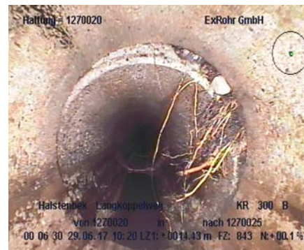
Bei einer Kamerafahrt entdeckt: Wurzeleinwuchs in ein Regenwasserrohr im Langkoppelweg
